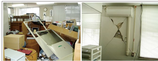
▲東日本大震災による歯学研究科の建物被害
